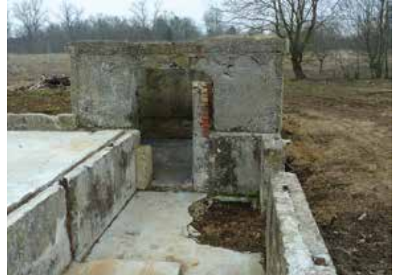
Abbildung 2: Ruine eines Waschhauses mit Kohlenkeller.
