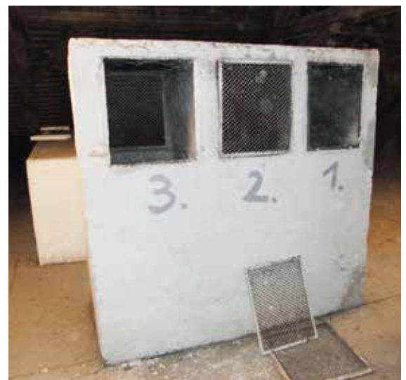
Abbildung 1: Abluftschächte des historischen Schachtlüftungssystems im Dachraum der untersuchten Schule in München.
