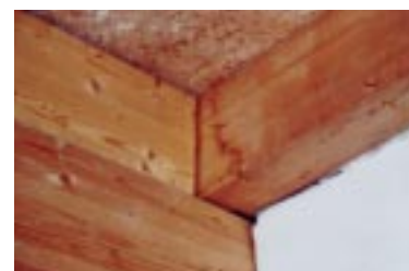
Bild 6: Wassereintritt durch Fuge infolge von Schwindverformungen
