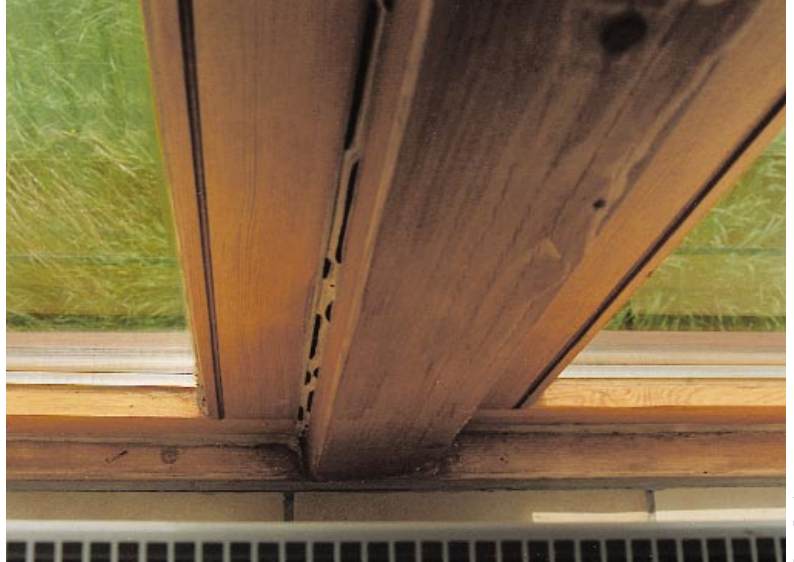
Bild 6: Abriss einer Silikon- fuge bei einem Fensteranschluss
