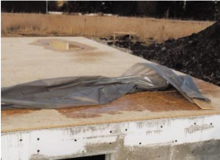
Bild 1: Unzureichender Schutz von Holzbau- teilen auf der Bau- stelle
