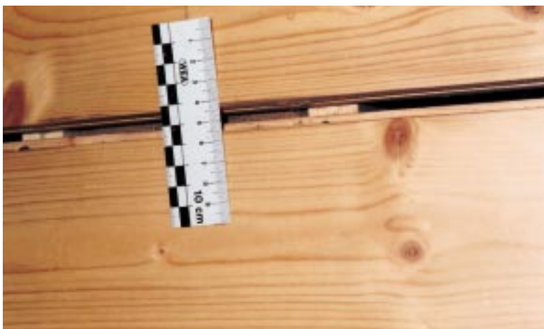
Bild 2: Große Fugen in Dielenfußboden
