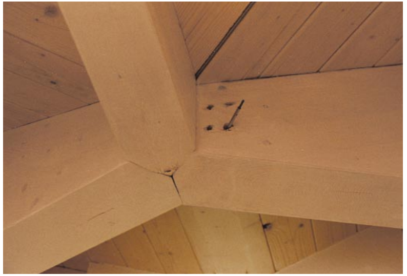
Bild 5: Stabdübelanschluss mit fehlenden Stabdübeln
