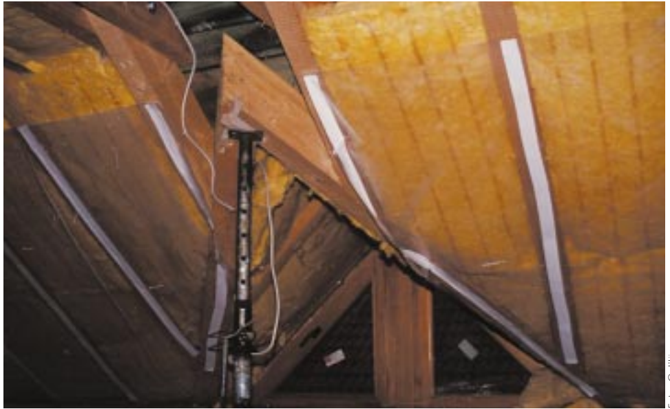
Bild 7: Fehler bei fehlender Statik: Dachgaube ohne Auflager
