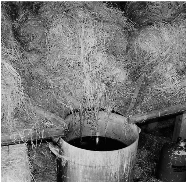
Bild 13. Unzulässig: Holzwool- dämmung ohne Verwendungsnachweis auf der Baustelle in Borsalz getränkt
