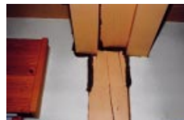
Bild 5: Wärmeverluste durch Fugen zwischen Holzständer und Ausfachung; Fugen notdürftig zugestopft
