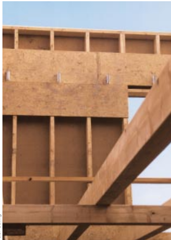
Bild 8: Anschluss der Decken- balken ohne Randgur- te: keine Übertragung von Deckenscheiben- kräften möglich
