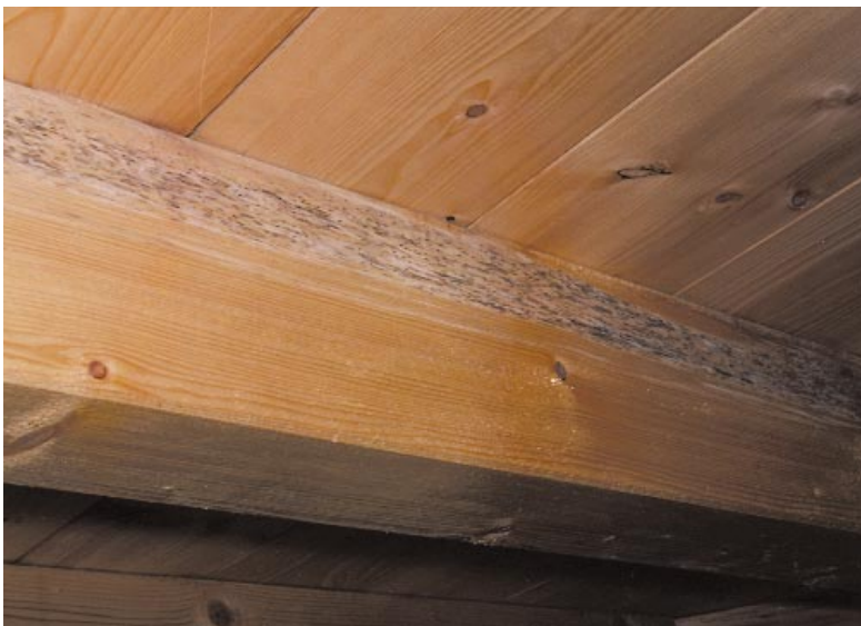
Bild 2: Schimmelpilzbefall bei sichtbarem Deckenbalken
