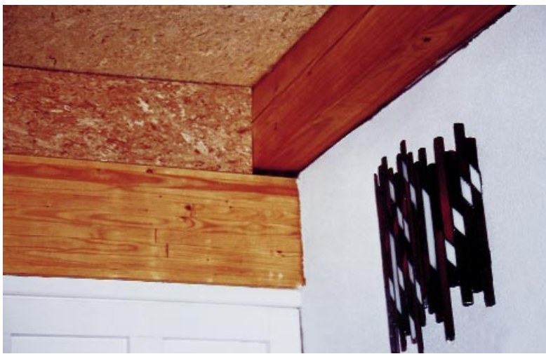
Bild 1: Streichbalken liegt nicht mehr auf Türsturz auf
