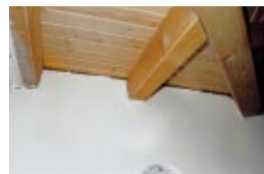
Bild 4: Fugen zwischen Deckenbalken und verputztem Mauerwerk
