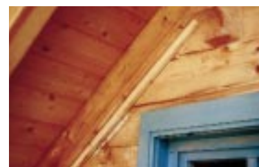
Bild 7: Tauwasserbildung auf der Außenseite infolge Luftströmung (Konvektion) durch undichte Fugen
