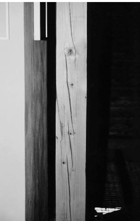
Bild 12: Bemängelte Rissbildung bei einer sichtbaren Holzstütze
