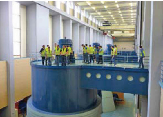
Lünserseerkraftwerk: Hier steckt Power drin.
