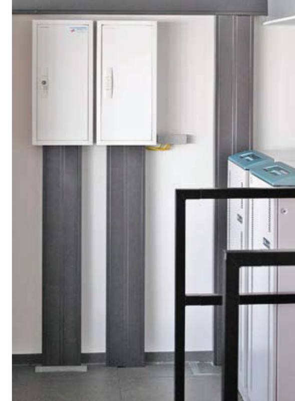
Doppelte Stromversorgung (links oben) und Notstromversorgung (rechts) im Serverraum.
