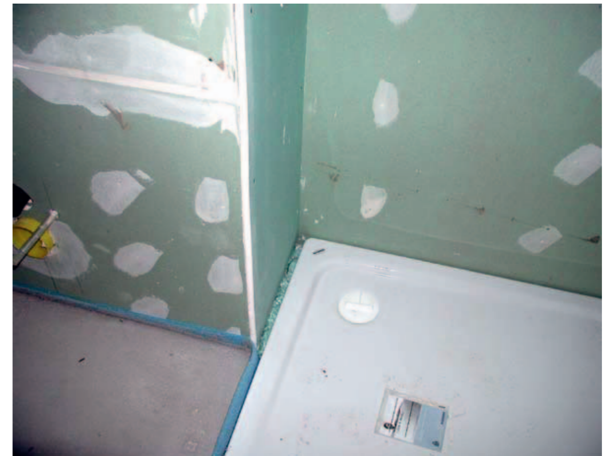
Abb.1: Ungelöstes Detail an einer Behindertendusche.
