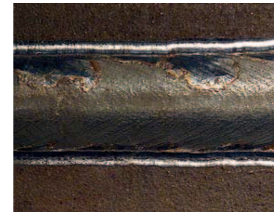
Schweißnaht nach dem Hämmern; beidseits der Nahtoberfläche ist die Vertiefung zu erkennen, die durch das Hämmern entstanden ist (Foto: Weich).
