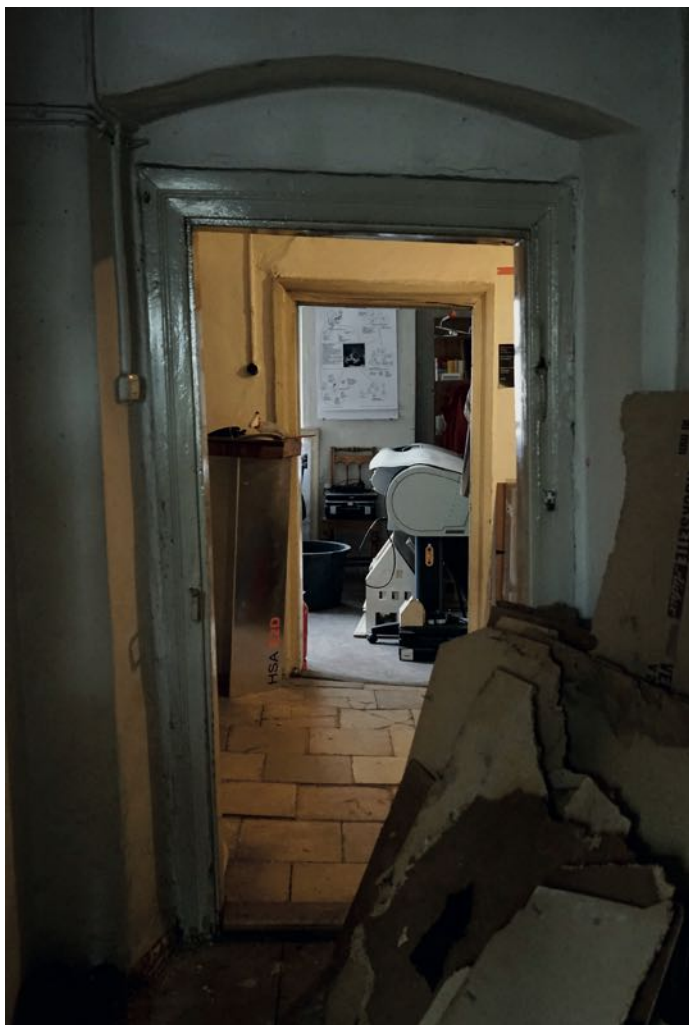
Aufnahme Befund 4, Tür 1.06 f mit Sparmauerwerk
