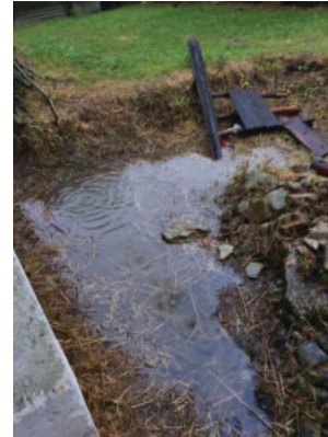
Überschwemmung des Lochs am Eingang
