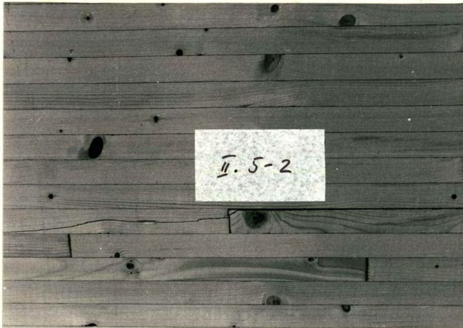
Bild 42: Fuge zwischen benachbarten Lamellen ( Träger II.5-2 ) im Keilzinkenbereich
