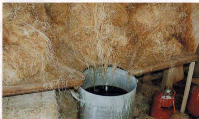
Bild 13: Unzulässig: Holzwoledämmung ohne Verwendungsnachweis auf der Baustelle in Brosalz getränkt
