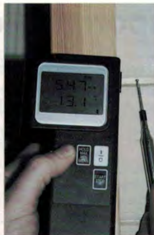
Bild 14: Gemessene Luftgeschwindigkeit von 5,47 m/s im Bereich einer undichten Nut-Feder-Schalung
