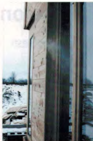
Bild 13: Austritt von Rauch/ Nebel aus Türanschluss
