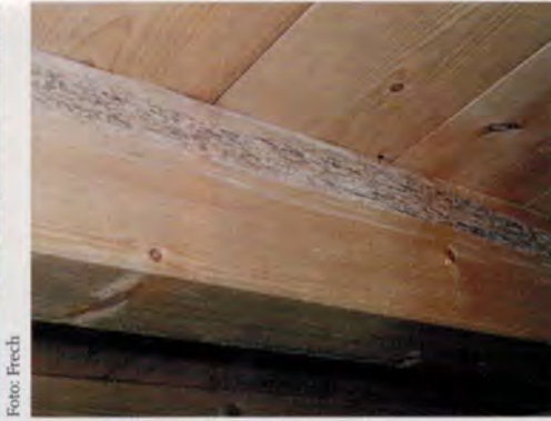
Linkes Bild 1: Unzureichender Schutz von Holzbauteilen auf der Baustelle
