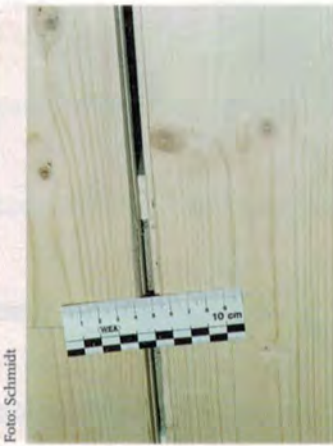
Bild 2: Streichbalken liegt nicht mehr auf Türsturz auf
