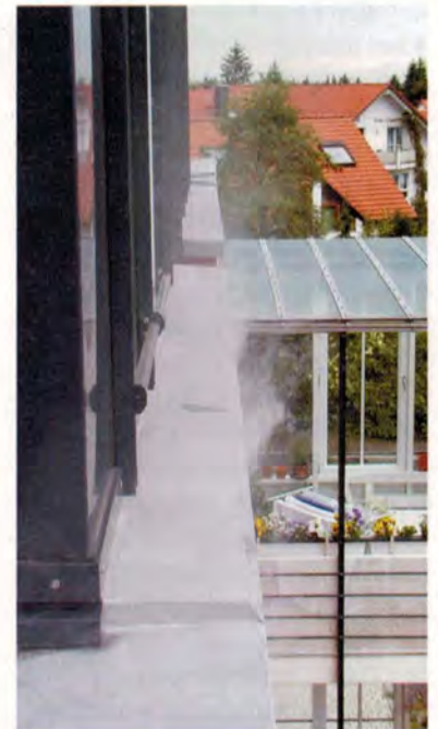
Bild 5: Nebelaustritt (Konvektion) durch undichte Fensteranschlüsse
