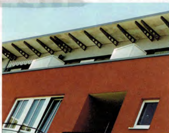
Bild 2: Schimmelpilzbefall am Dachüberstand (Stand: April 2001)
