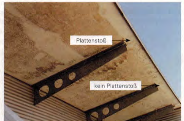
Bild 6: Verstärkter Pilzbefall im Bereich eines Plattenstoßes
