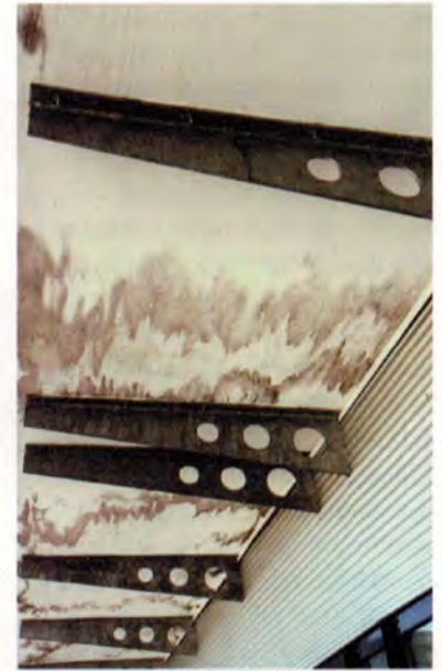
Bild 3: Der Pilzbefall folgt der Maserung des Deckfurniers (Stand: April 2001)
