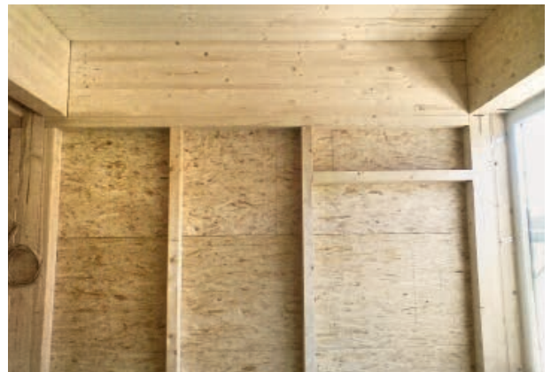
▲ Wandtafel mit zwei unzulässigen freien Plattenrändern (nicht unterstützte Plattenstöße)
